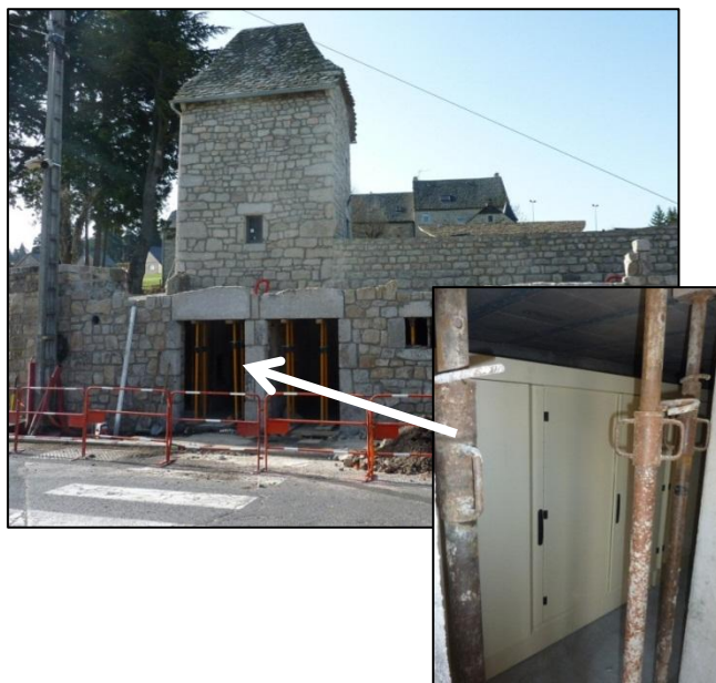
Figure 11 : Exemple de PM bénéficiant d'une intégration paysagère
