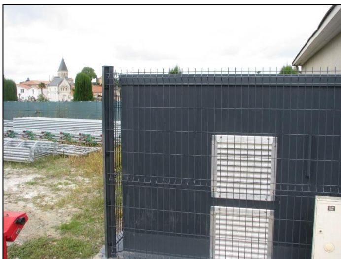
Figure 12 : NRO (à droite) peint en gris foncé sur prescription de l'ABF en raison de sa localisation dans le périmètre de l'église classée monument historique (à gauche)
